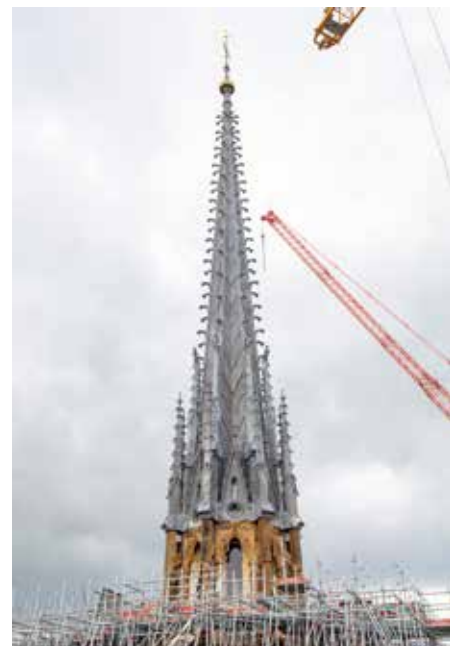
Der neue Spitzturm wurde aus Eichenholz gefertigt, das aus nachhaltig bewirtschafteten Wäldern in Frankreich stammt. Um die Konstruktion vor Witterung zu schützen kommt, wie auch schon vor dem Brand, eine Bleiverkleidung zum Einsatz.
