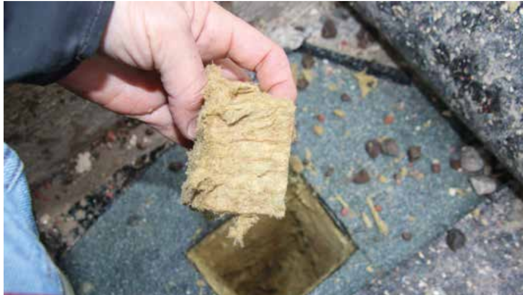
Die Steinwolle ist in den unteren Schichten staubtrocken. Ein Flüssigwassereintritt ist deswegen schon nicht logisch.
