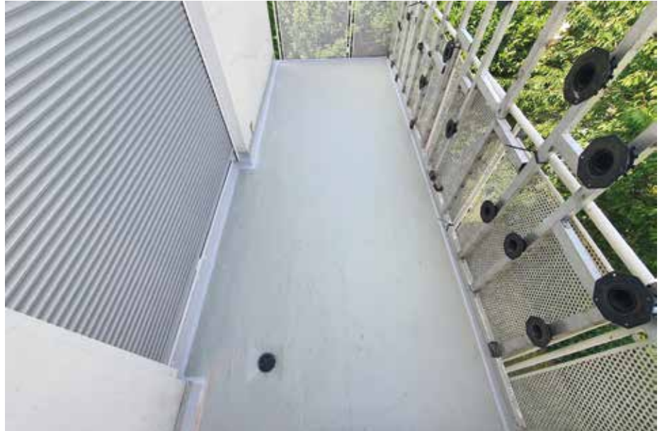
Mit dem Balkon Entkopplungssystem Triflex ProDrain, in Verbindung mit dem Balkon Abdichtungssystem Triflex BWS auf Basis von Polymethylmethacrylatharz (PMMA), haben die Verarbeiter der Spenglerei & Metallbau Fladischer einen durchfeuchteten Balkon in Graz mit einer neuen Abdichtung versehen. | Fotos: © Triflex (4)
