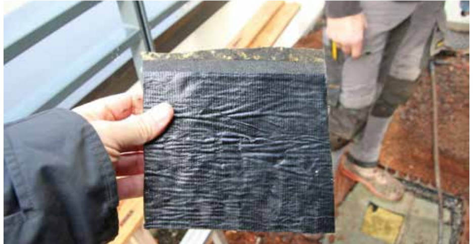
Die Unterseite der Abdichtung ist bei etwas wärmerer Außentemperatur völlig trocken. Bei der ersten Bauteilöffnung war bei kühlerem Wetter diese feucht und es wurde auf eine Undichtheit geschlossen. Ein Feuchtigkeitfilm unter der Abdichtung ist kein eindeutiges Zeichen für eine Leckage.
