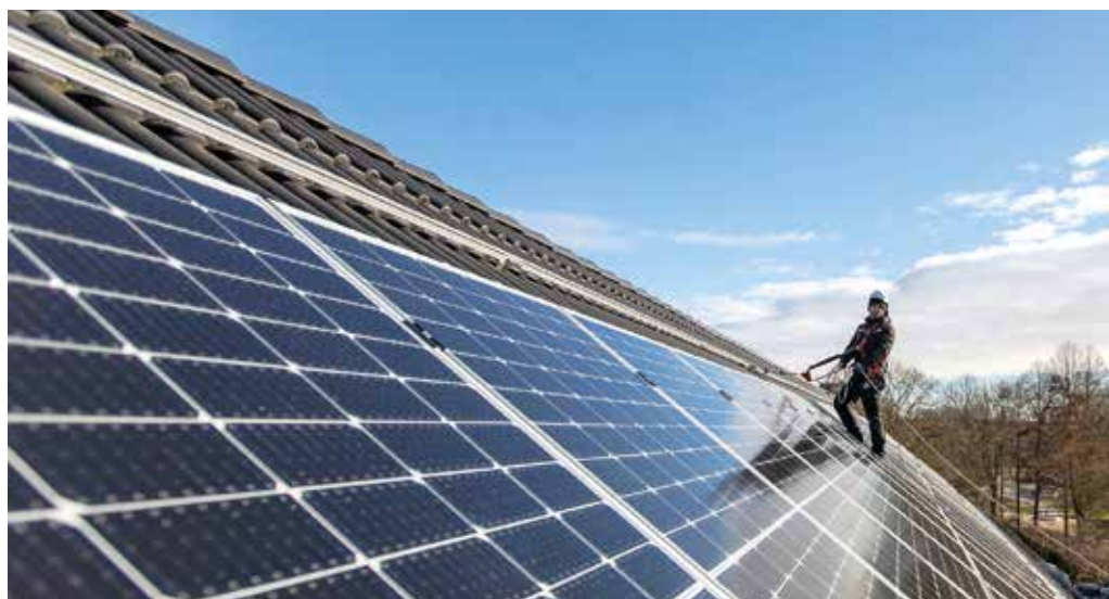
Optimal auf Steildächern mit PV-Modulen: das Schienensystem LUX-top FSA 2010-H. Foto: © ST QUADRAT Fall Protection S.A
