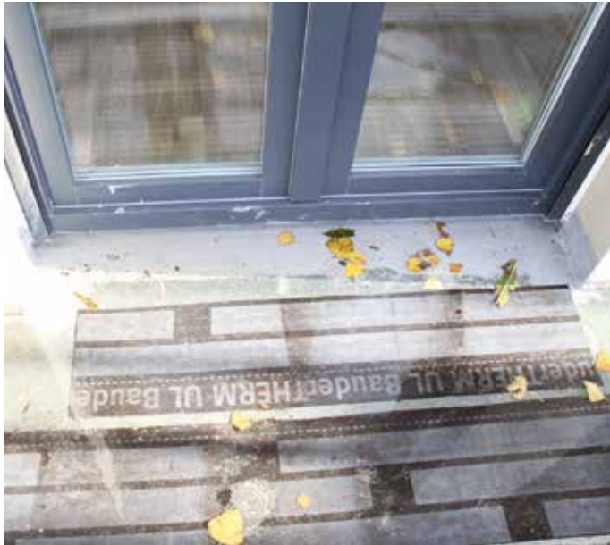
Die zurzeit erste mögliche Entwässerung der Terrasse über die Terrassentüre nach innen in das Objekt.
